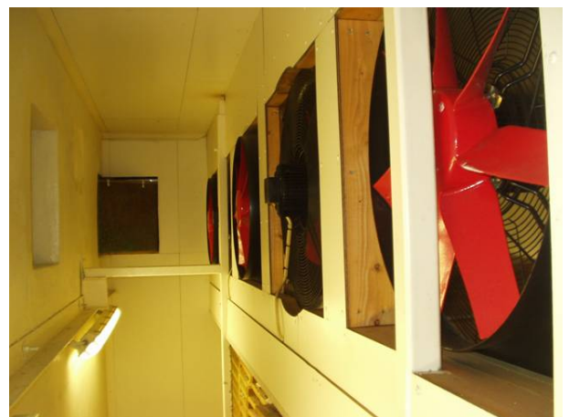
Figur 21. Bilde av hovedvifter plassert langs ene kanten av himlingen.
